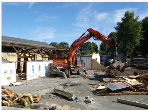
Destruction de la MPT/CS 3 août 2015
